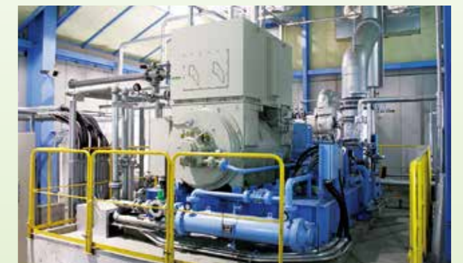
蒸気タービン発電機
