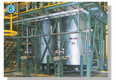
フレーク洗浄装置
