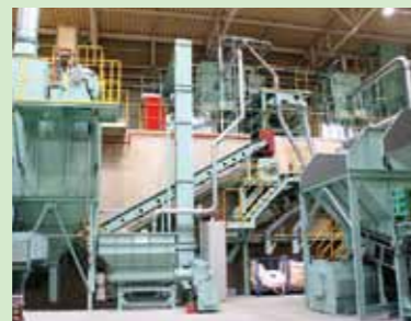
廃石膏ボードリサイクル処理設備
