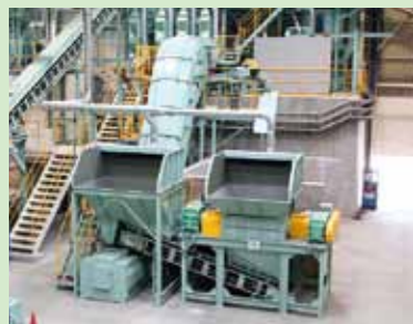
廃プラ・可燃物破碎圧縮梱包処理設備
