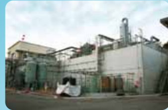
パイオ排水処理施設
